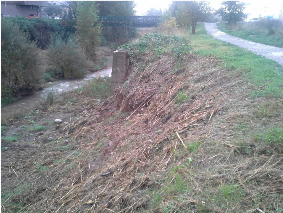
Imatge 7. Vista de la zona de transició entre el talús i el mur de formigó al marge dret a l'alçada de la secció G abans de la riuada del dia 30/11/2014. El fons s'observa la passera peatonal i ciclable de la Doma.
