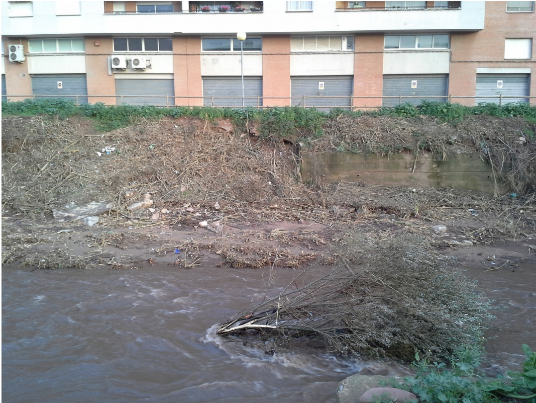
Imatge 11. Vista de la transició del mur de formigó i el talús del marge esquerre posterior a la riuada del dia 30/11/2014 (secció G).
